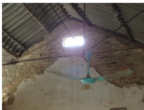
内壁の一部が剥離している教室
