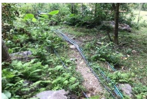
給水のためのパイプ(村民家庭用。小学校への配水はなし)
