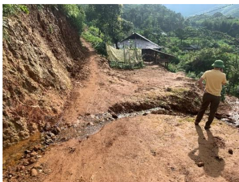
Lún sụt ở điểm đầu con đường
