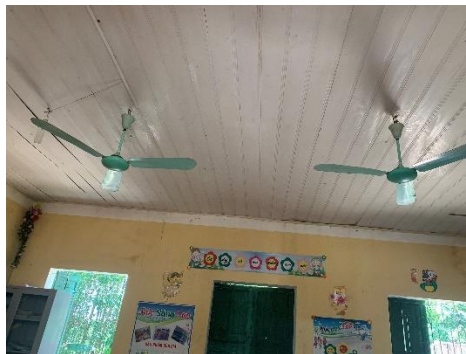
Trần nhà đã xuống cấp, tường bị ẩm mốc
