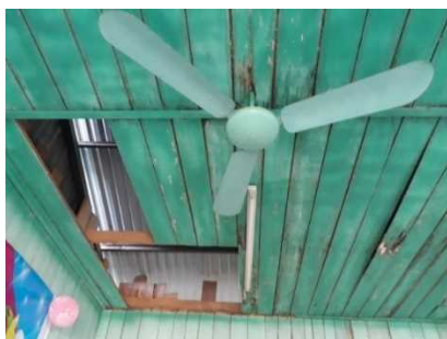
Hiện trạng trần nhà
