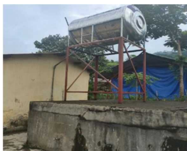
Bể chứa nước của trường tiểu học thôn Cốc Phát
