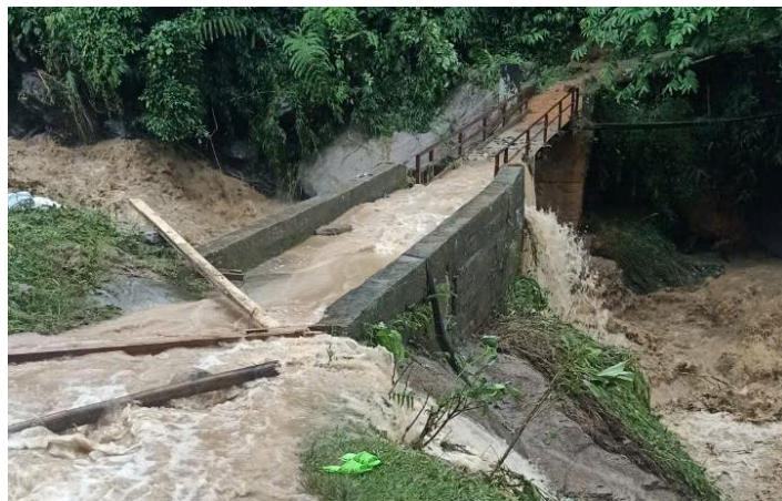
Hình ảnh cầu Lò Suối Tùng hiện tại bị hư hỏng nặng bởi cơn bão số 3 (bão Yagi)
