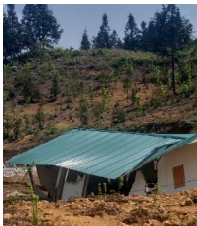
Nhà cộng đồng cũ tại thôn Lao Chải bị phá hủy hoàn toàn do sạt lở đất trong cơn bão số 3 (Yagi)
