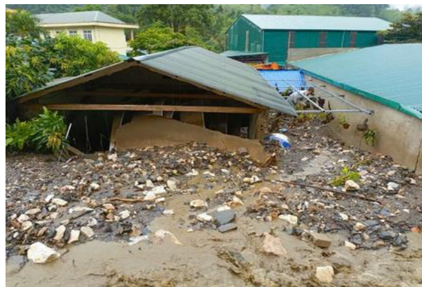
Nhà dân bị sập do sạt lở đất trong cơn bão số 3 (Yagi)
